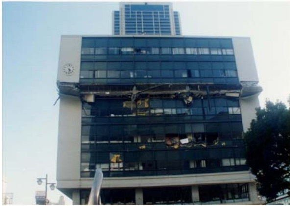
写真—1 2 阪神淡路大震災神戸市庁舎の被害
