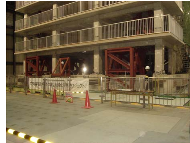
補強前損傷状況 1
