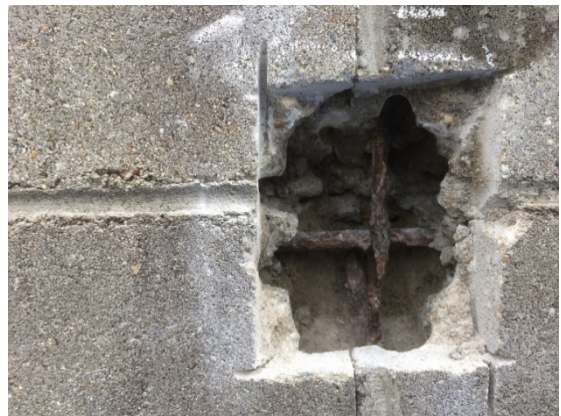
写真 4 縦筋の破断 (転倒危険度 1.96、 H=1.65\text{m} )
