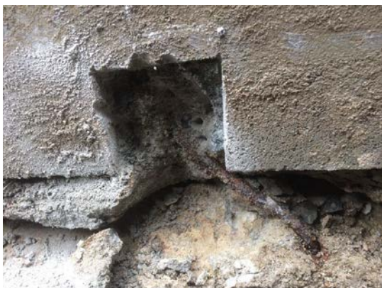
写真 2 基礎部縦筋破断 (転倒危険度 3.75、 H=1.10\text{m} )
