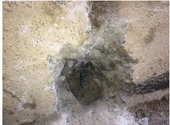
写真 3 基礎との定着無し (転倒危険度 3.14、 H=1.20\text{m} )
